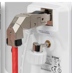
directe aansluiting – IP-camera
